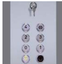
Standardschlüssel in der Kabine
